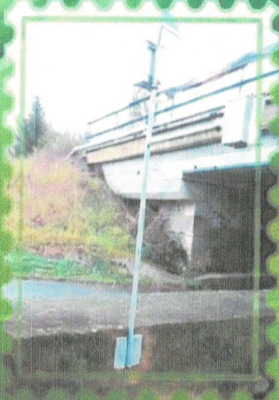
Protipovodňová opatření - hladinoměr
